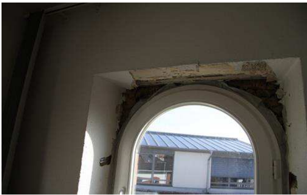
Fehlerhaft eingebautes Gaubenfenster im Dachgeschoss des alten Rathauses.
