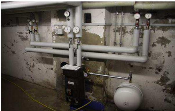
Fernwärmeanschluss im Keller des Betriebsgebäudes.
