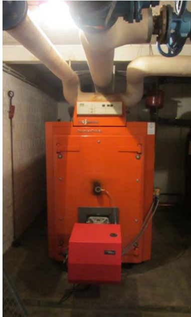
375 kW Öl-Kessel, Baujahr 1997
