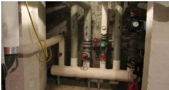
Heizkreis für Turnhalle (rechts) mit geregelter Effizienzpumpe
