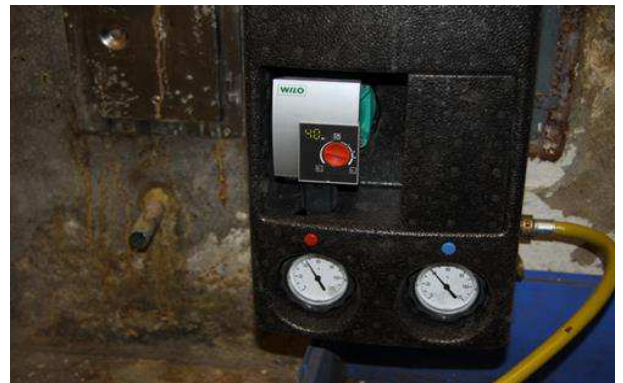
Fernwärmeanschluss im Keller des Betriebsgebäudes
