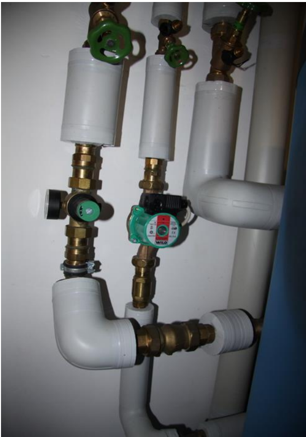
Ungedämmte Armaturen und Verschraubungen
