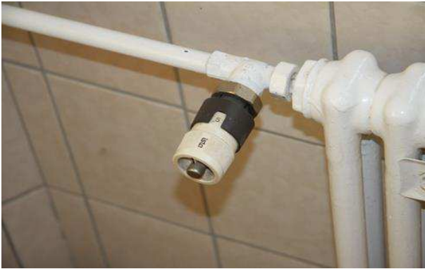
Altes 2K-Ventil mit Thermostat im Waschraum
