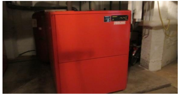
700 l Warmwasserbereitung Baujahr 1997
