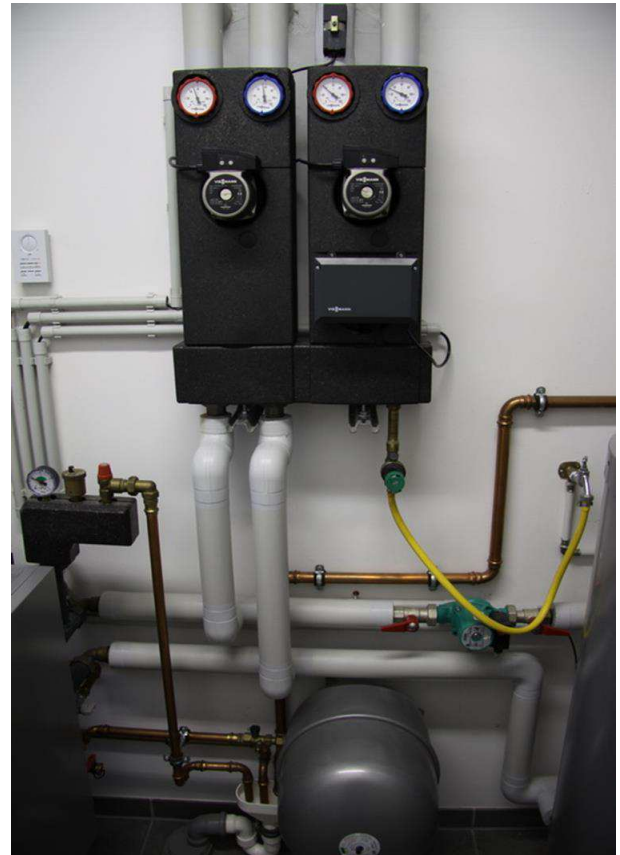
Gut gedämmte Heizungsverteilung mit Effizienzpumpen.
