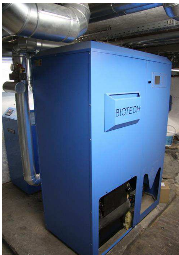
Pellet-Kessel für die Grundlast der Wärmeversorgung
