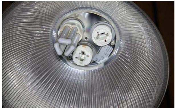
Beleuchtung mit Kompaktbeleuchtung im Schulungsraum
