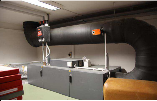
Neu Lüftungsanlage im Bereich des Geräteraumes
