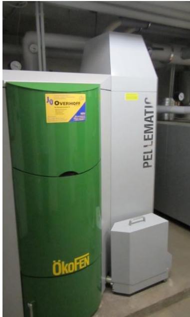
Holz-Pellet-Heizung 56 kW, Bj. 2011
