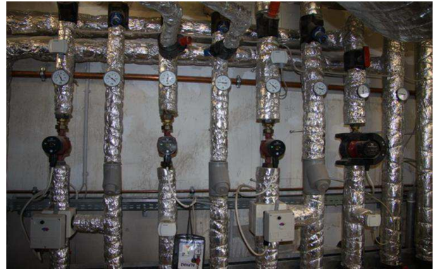
Gut gedämmte Heizungsverteilung mit ungedämmten Hocheffizienzpumpen.
