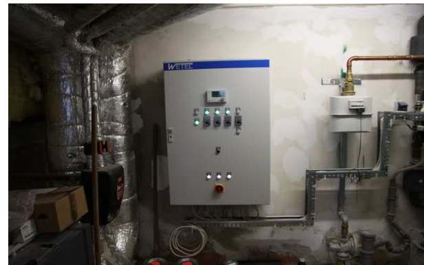
Steuerungsanlage für Heizung und Warmwasser
