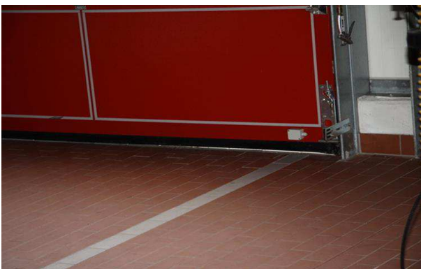
Nicht dicht schließende Hallenrolltore
