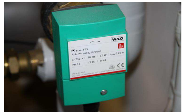
Zeitgesteuerte Zirkulationspumpe für die Warmwasserversorgung.
