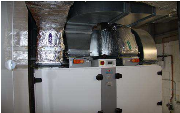
Lüftungsanlage für das Vereinsheim
