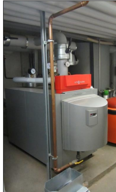
Erdgas-Spitzenkessel mit Brennwerttechnik 142 kW Bj. 2011 Heizungsspeicher ca. 1000 l im Hintergrund
