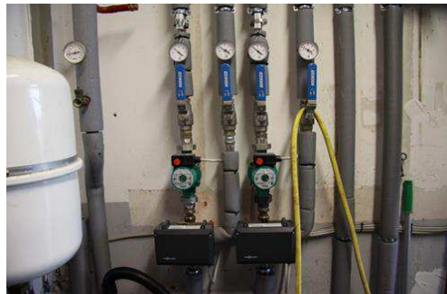
Heizungsverteilung im Technikraum des Erdgeschosses
