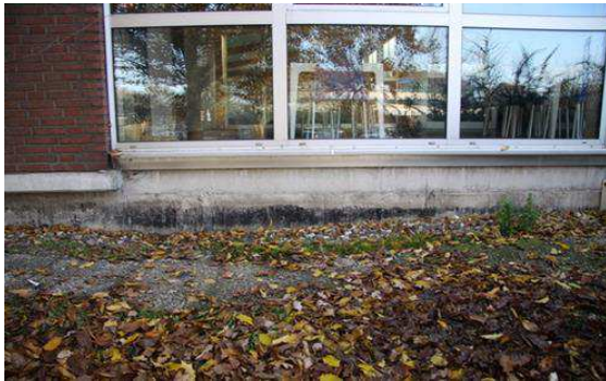
Ungedämmter Sockelbereich (hier an der West-Seite) des Hallenbades. Diese Wärmebrücke sollte beseitigt werden.
