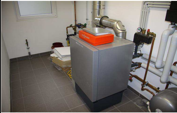
Gut aufgeräumte und saubere Heizzentrale.
