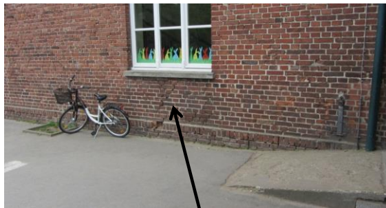
Rissbildung vom Sockel bis einschließlich der Fensterbank im EG
