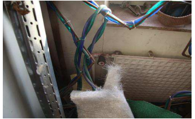
Zugestellter Heizkörper in der Werkstatt mit altem Heizkörperventil
