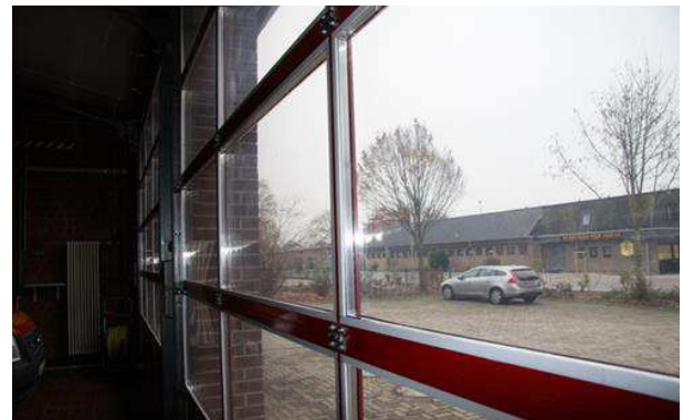
Kunststoffdämmscheiben in den Rolltoren der Fahrzeughalle.
