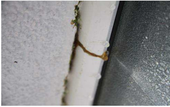
Schwitzwasser tritt am Fensterrahmenanschluß zum WDVS wegen mangelnder Abdichtung aus.
