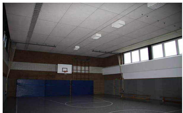
2 Reihen Leuchtstoffbeleuchtung im Fensterbereich. Im mittleren Bereich besteht die Beleuchtung aus Quecksilberdampf-
