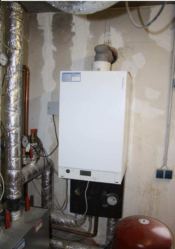
Brennwerttherme für die Beheizung und Warmwasserversorgung der Sporthalle.
