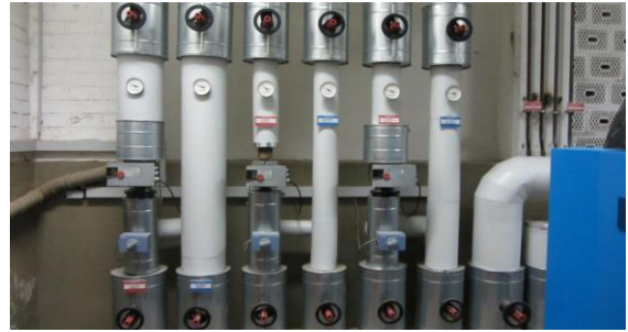
Heizungsverteilung mit Effizienzpumpen und vollständiger Isolierung
