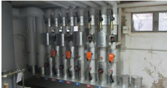
Heizungsverteilung vollständig gedämmt
