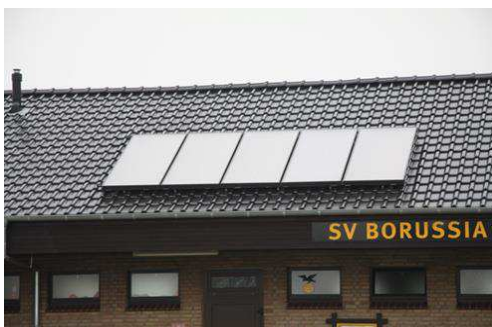
Solarpaneele für die Heizungsunterstützung und Warmwassererzeugung
