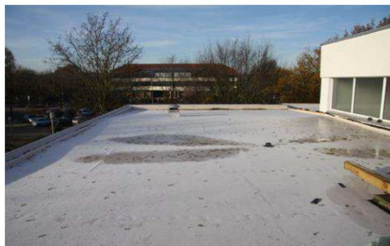
Fehlerhaft geplante und sanierte Flachdachfläche mit Dacheinlauf an einem Hochpunkt.
