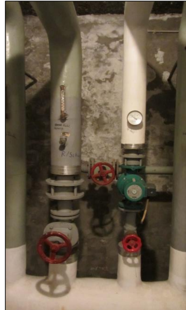
Heizungsverteilung, Heizkreis Schule mit unregelter Umwälzpumpe
