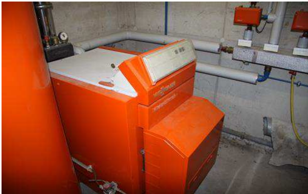
Niedertemperaturkessel mit Ölfeuerung für Heiz- und Warmwassererzeugung.
