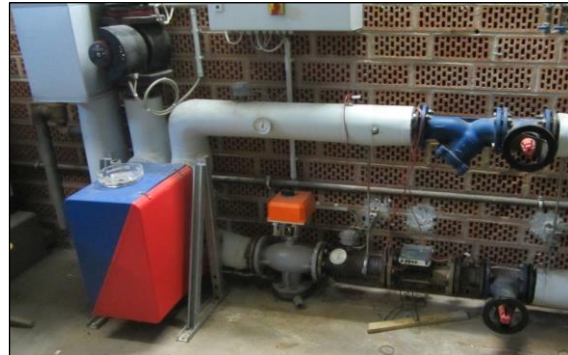
Wärmetauscher, als Hauptheizung wird über ein Nahwärmenetz die Abwärme einer Biogas-Anlage genutzt
