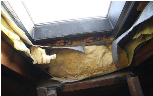
Fehlerhaft eingebautes Dachfenster.
