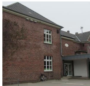
West-Ansicht des Altbau mit Bauschäden
