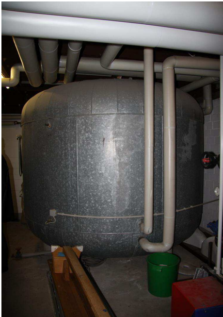
10.000 ltr. Warmwasserspeicher aus dem Jahr 1981
