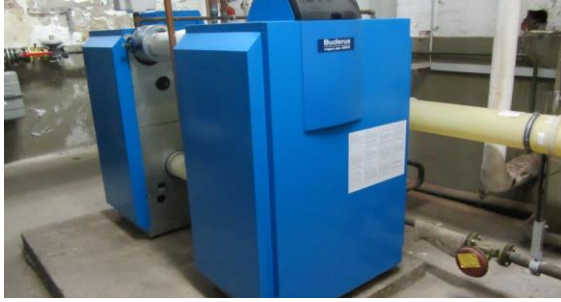
Erdgas-Brennwert-Wärmeerzeuger als Doppelkessel-Anlage Bj. 2009
