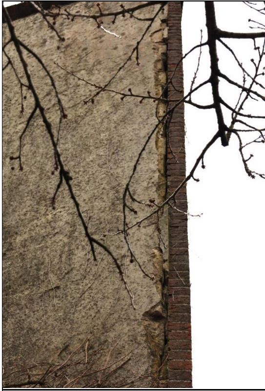
Bild 10: Mauerspalten an der südwestlichen Gebäudecke (eigene Aufnahme, 04.03.2024)
