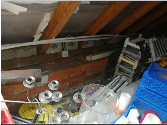
Bild 7: Der Abstellraum neben der Kegelbahn ist zur östlichen Dachkante dicht geschlossen. (eigene Aufnahme, 04.03.2024)
