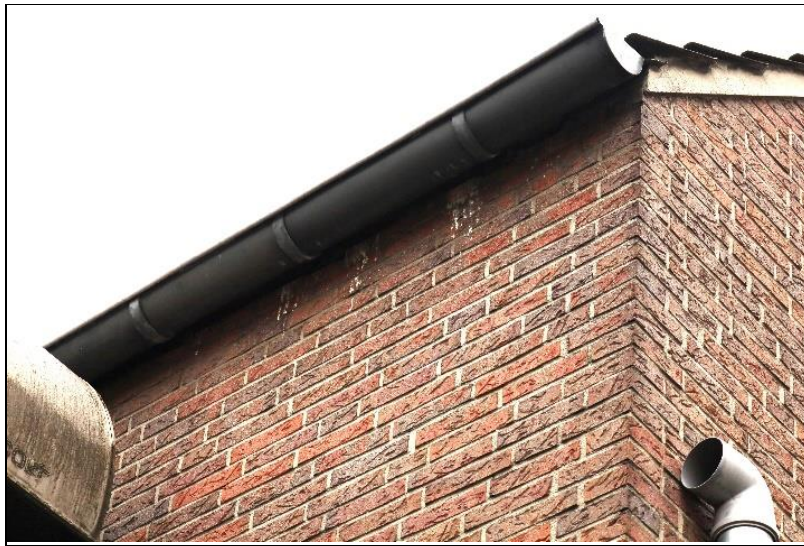
Bild 12: Schmelzspuren an der rückwärtigen Hauswand des höheren Gebäudeteils (eigene Aufnahmen, 04.03.2024)
